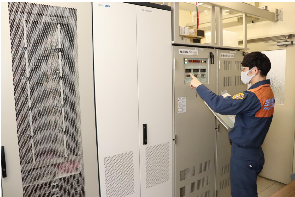
消防本部の通信設備定期点検
