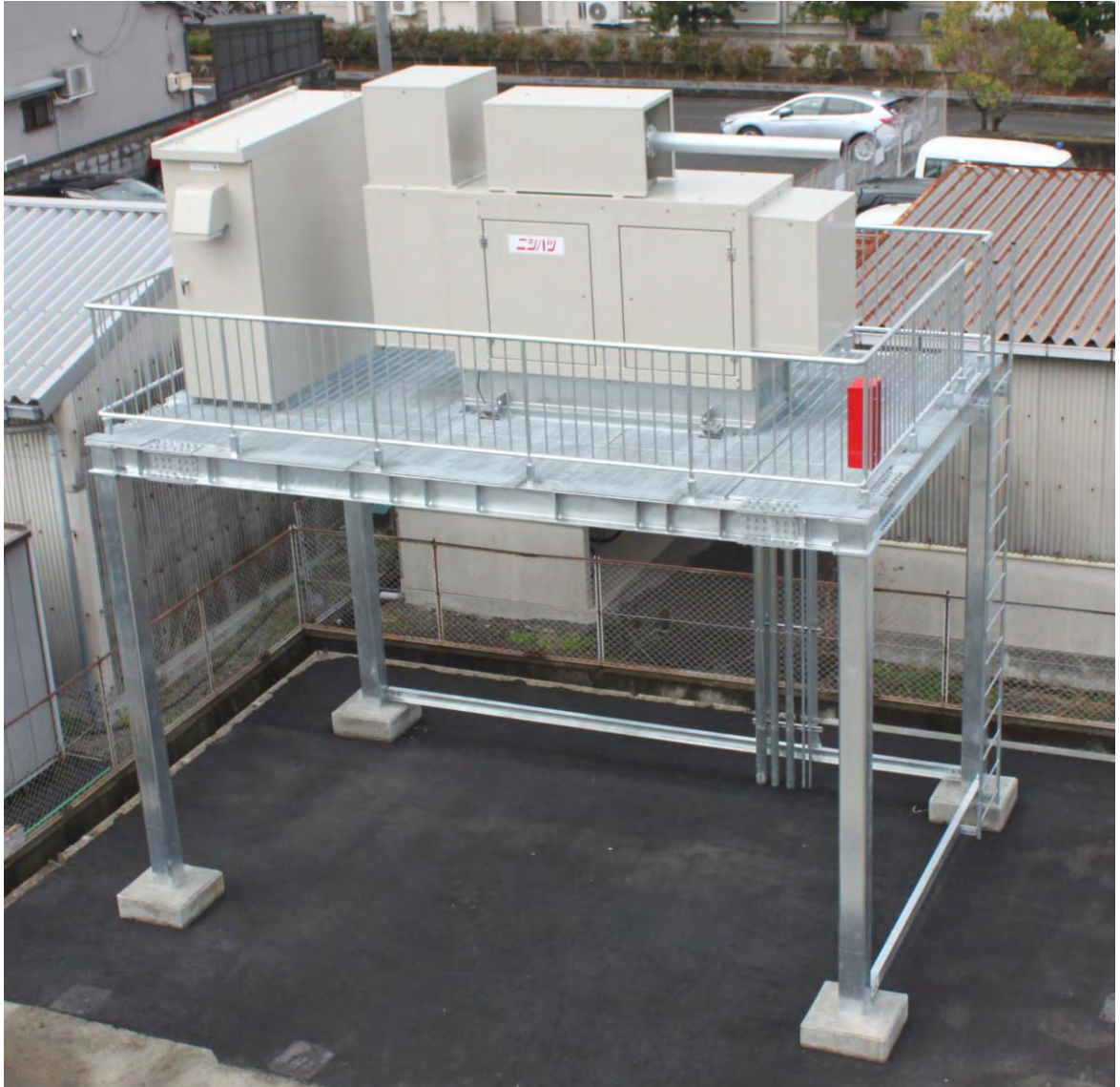
津波浸水対策として、高所へ移設した自家用発電設備
